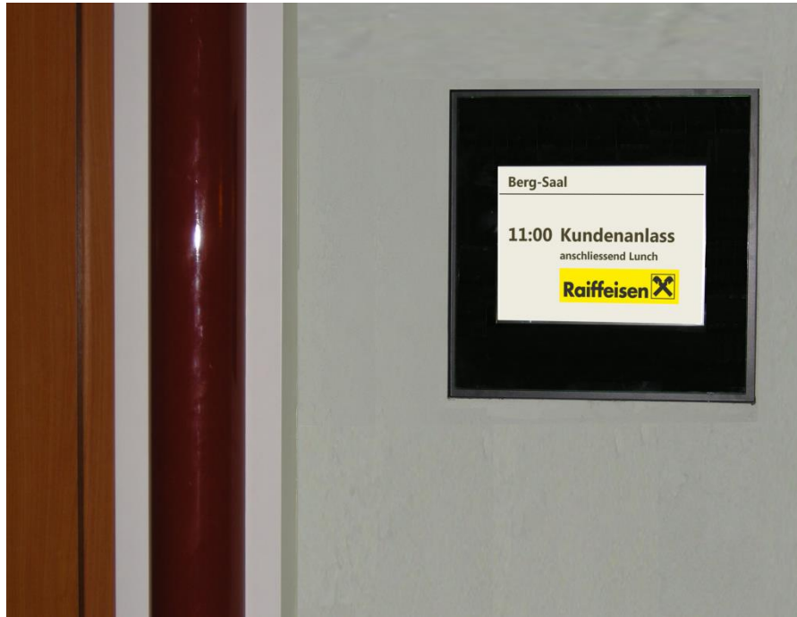
10.4" Display in die Wand eingelassen
